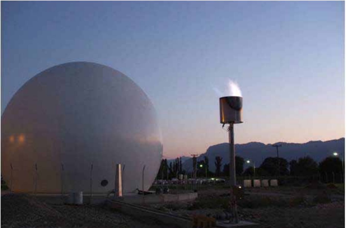
Stockage du biogaz
