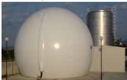
1 digesteur VALBIO METHACORE® de 200 m 3
