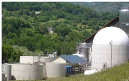
1 digesteur VALBIO METHACORE® de 280 m 3
