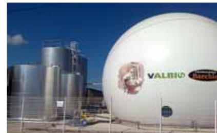
2 digesteurs VALBIO METHACORE® de 125 m 3
