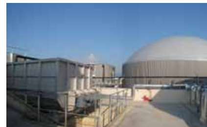
1 digesteur VALBIO METHAMIX de 1 300 m 3
