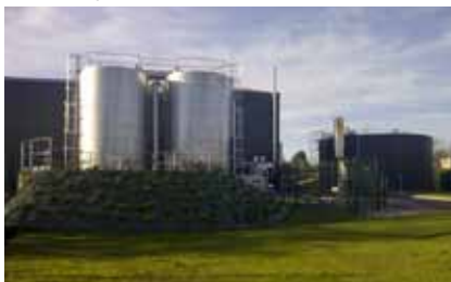
2 digesteurs VALBIO METHACORE® de 125 m 3
